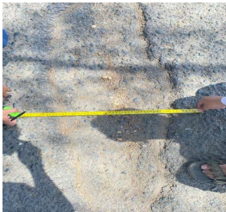
Gambar 2. Kondisi Kerusakan Ruas Jalan
