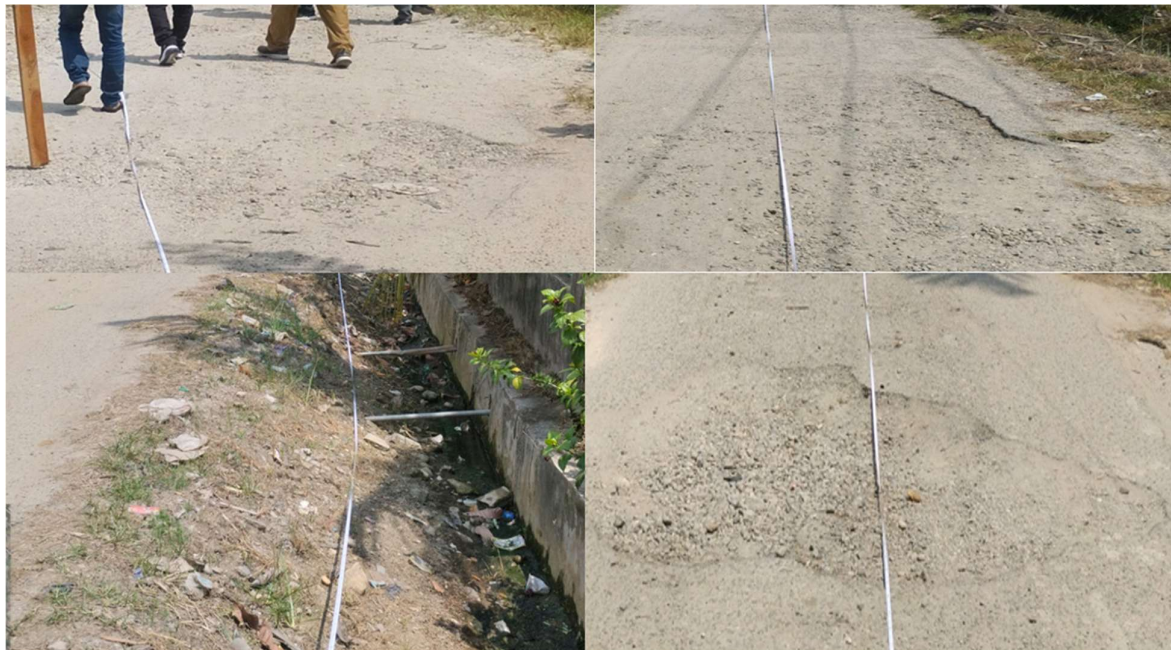
Gambar 3. Dokumentasi Kerusakan Jalan di STA 0+000 s.d 0+100 dan 0+400 s.d 0+460
