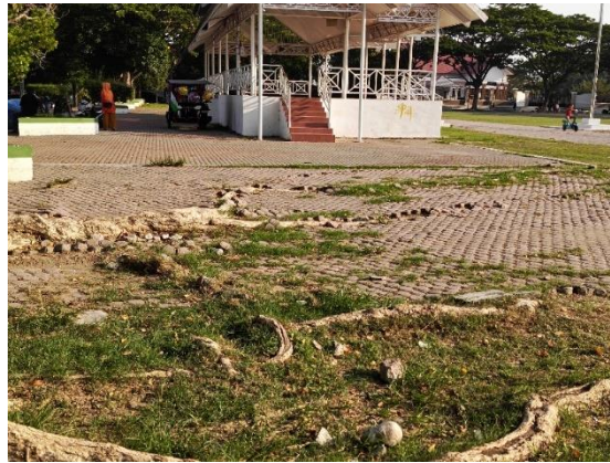
Gambar 10. Fasilitas rusak pada Lapangan Hiraq
