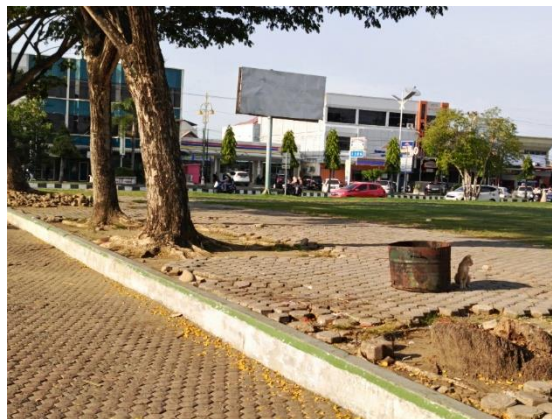
Gambar 11. Fasilitas rusak pada Lapangan Hiraq
