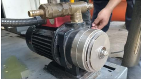
Gambar 2. Kebocoran cairan coolant pada sambungan flange antara motor dan badan pompa Walrus TPH 2T 3K sebelum perbaikan.
